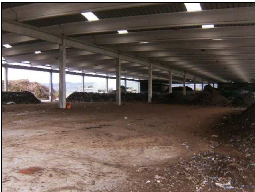
Centre Comarcal de Tractament de Residus. Planta de Compostatge
